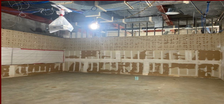
EDIFICIO K—SALA 118 LABORATORIO DE PIANO
