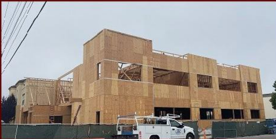
KING CITY - NUEVA AMPLIACIÓN CUBIERTA CON MURO CORTANTE ANTICIPANDO LA INSTALACIÓN DE LAS VENTANAS
